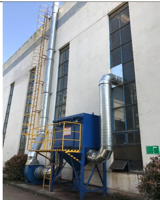
机器人焊接和自动打磨废气排气筒
