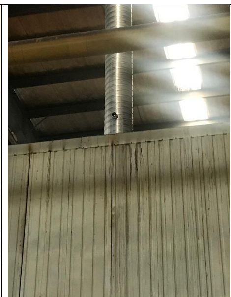
电泳天然气烘炉废气排气筒
