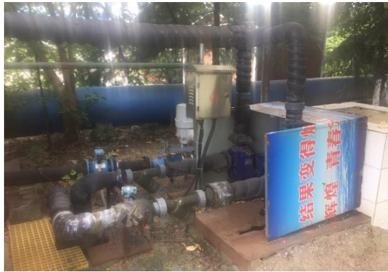
废水监测井及排口
