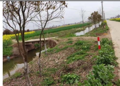
图 2-4 桥梁建设标准低，无法满足农业生产（20+730）
