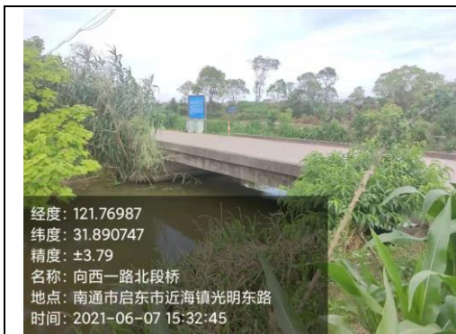
图 2-1 桥梁建设标准低，无护栏防护
