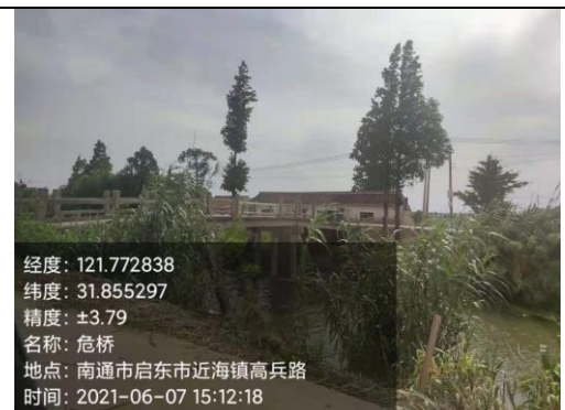
图 2-2 桥梁建设年代久远，破损严重
