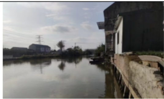
图 3-3 岸坡坍塌现状图
